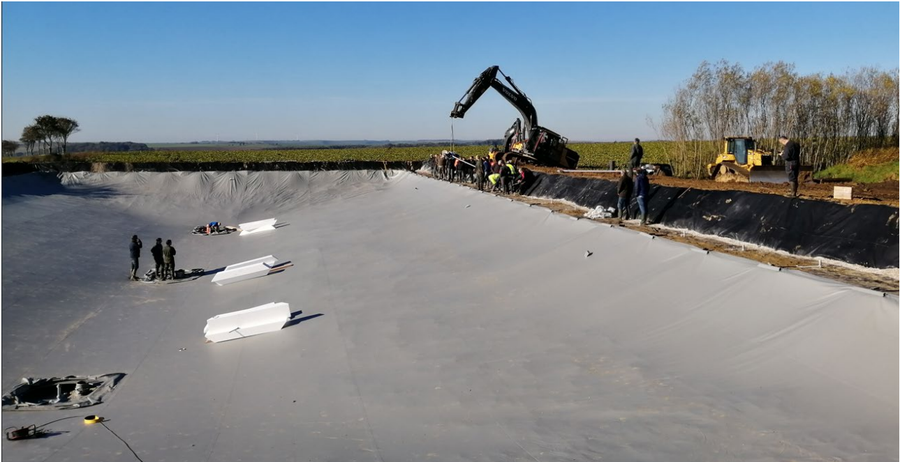
Figure 10. Photographie de l'installation d'une des lagunes déportées de la SAS LANDACRES ENERGIE
